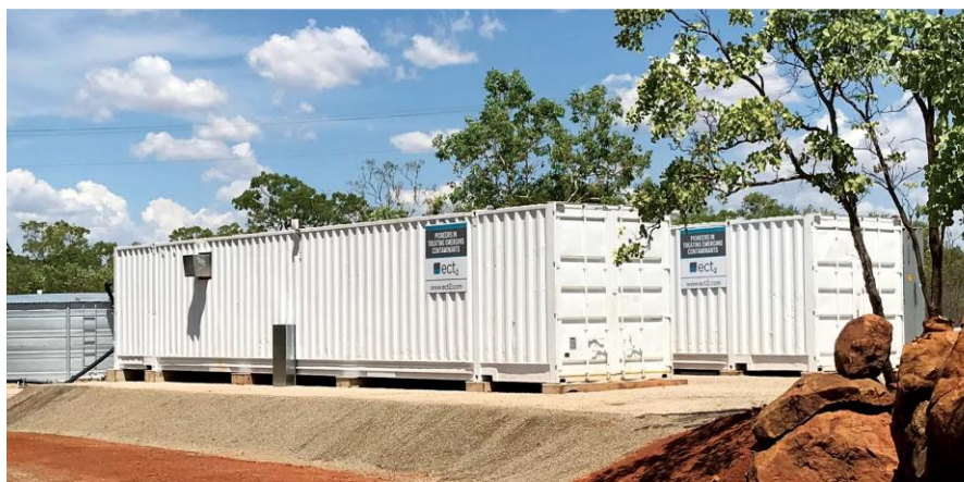
Figur 9. 13 l/s dricksvattenreningsystem i Katherine, Australien.
